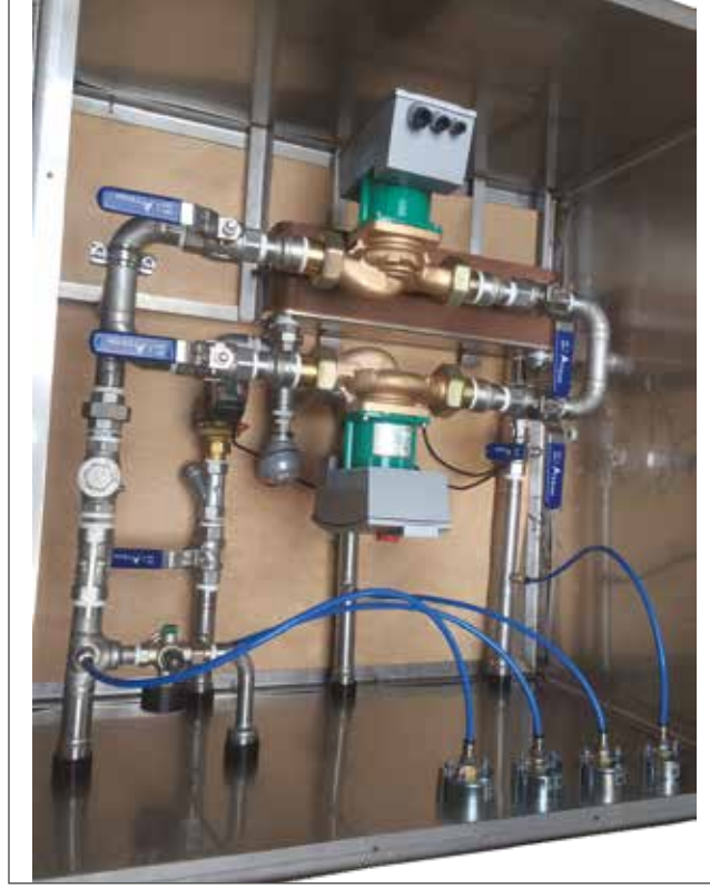
Chiller ile üniteler arasında devre ayırma cihazıdır.
