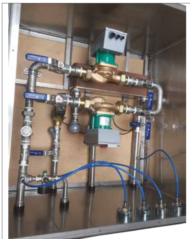
Устройство разделения системы между блоками и чиллером.
